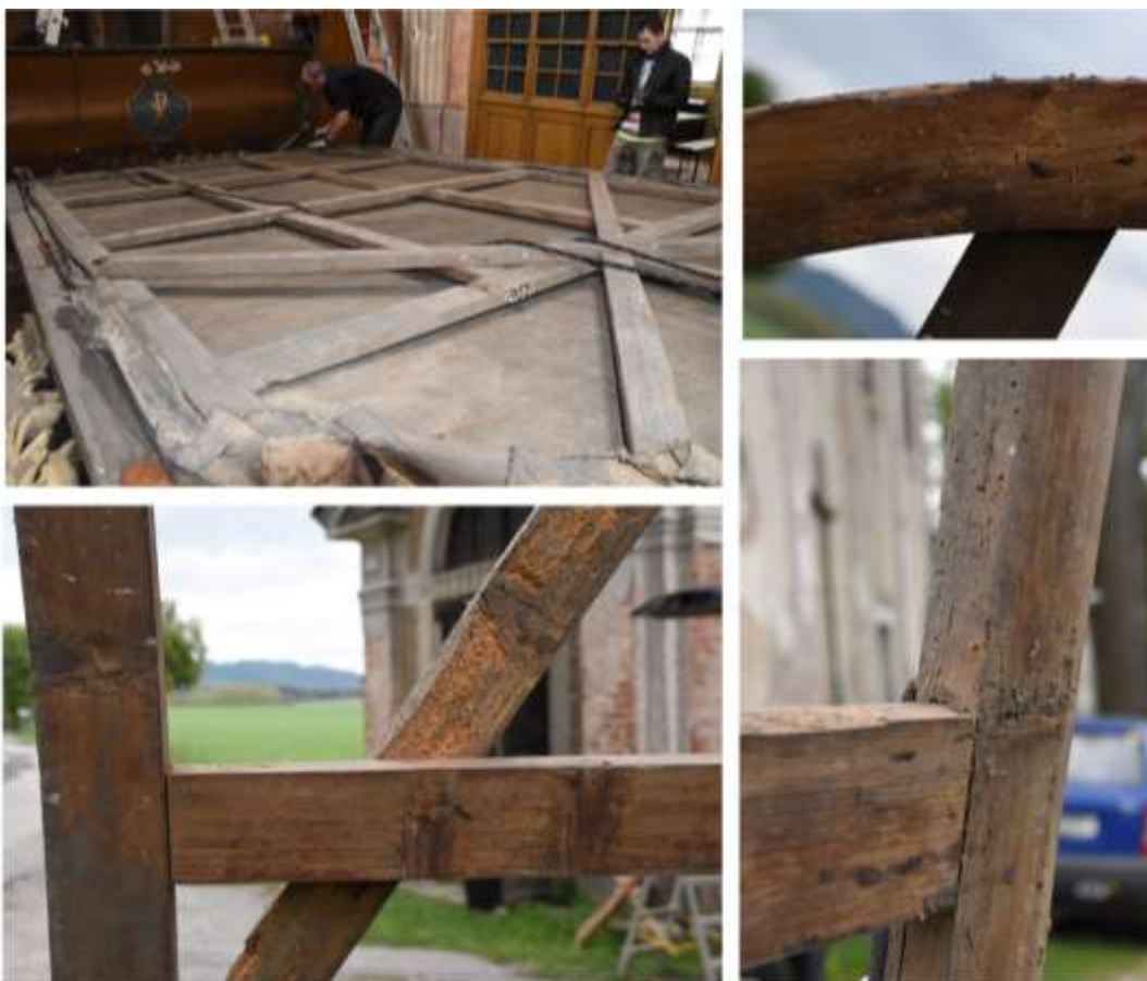
Stav původního rámu
